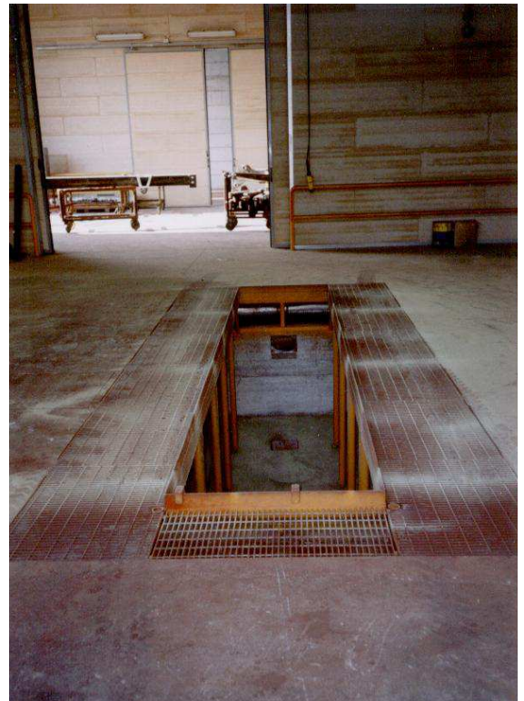
Fossa di aspirazione →
